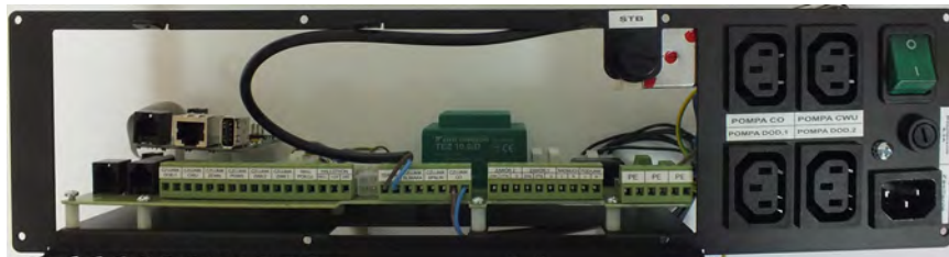
Rysunek 2 Listwa przyłączeniowa do zasilania urządzeń regulacyjnych (uwaga fot. przedstawia przykładowe rozmieszczenie podłączeń, szczegóły w dołączonej DTR sterownika).
